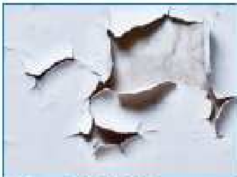
Peinture CLASSIQUE appliquée sur un mur contenant de l'humidité. L'humidité pousse la peinture qui se décolle
